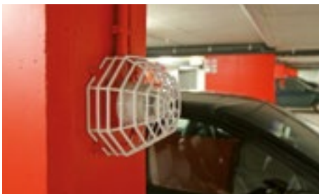
2/3. CO- und Flüssiggassensoren - Bei Überschreiten von frei wählbaren Grenzwerten werden die Systemkomponenten automatisch aktiviert und angesteuert.
