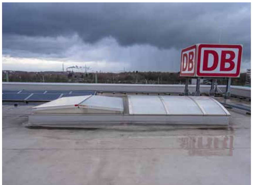
Die Lichtstraße Cosmotron bringt Licht in die Werkshalle, die Haubenlüfter vom Typ Apollo sorgen für den Brandschutz
