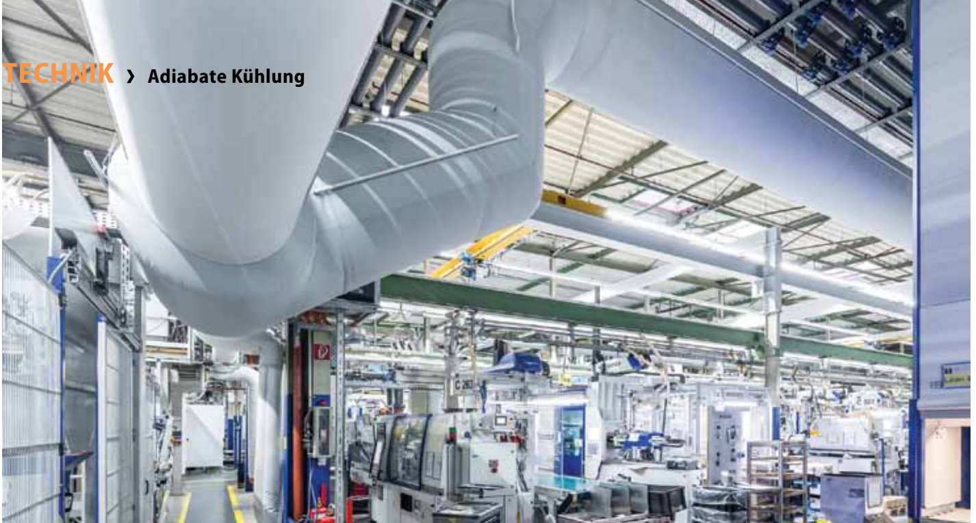
Die horizontalen Gewebeschläuche schaffen adäquate klimatische Arbeitsbedingungen.
