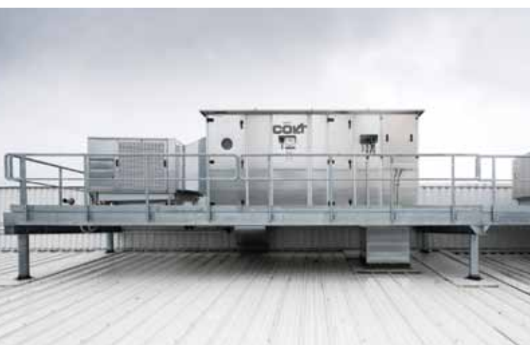
Colts Lösung: Eine Mischung aus dem adiabatischen Kühlsystem „CoolStream“ und einer Be- und Entlüftungsanlage
