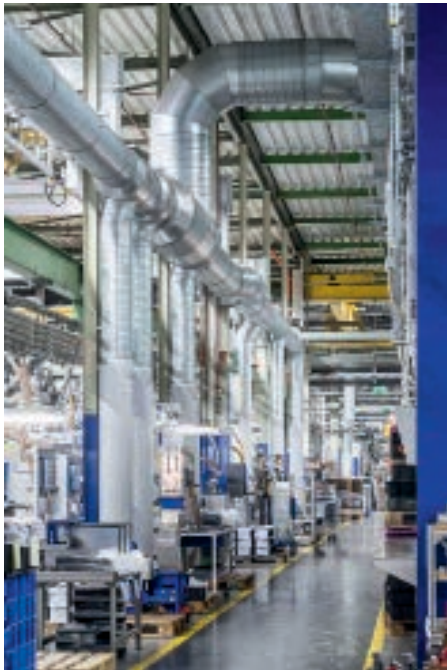
Lösung für das Temperaturproblem: adiabatisches Kühlsystem und eine Be- und Entlüftungsanlage, die nach dem Prinzip der Schichtlüftung arbeitet
