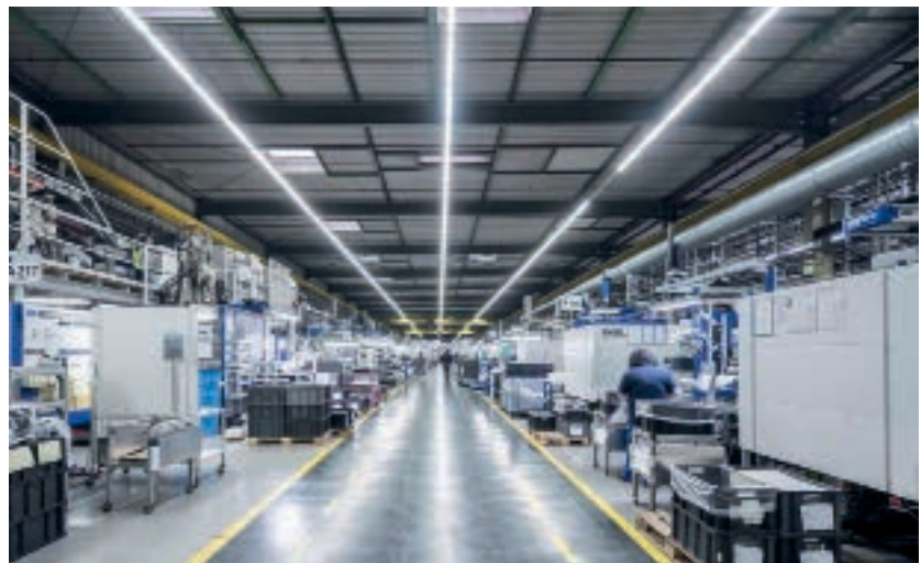
Liegt die Außentemperatur bei rund 32 °C, sorgt die installierte Anlage trotz der massiven thermischen Belastung in den Produktionsstätten für angenehme Temperaturen und eine hohe Luftqualität.
